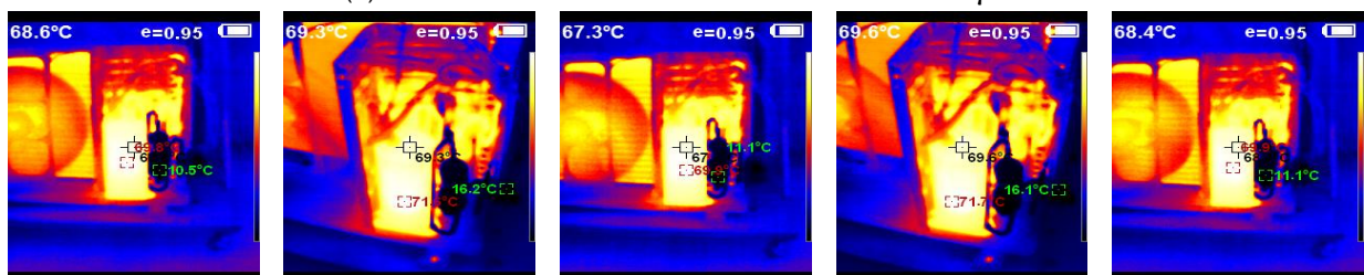
(ง) ภาพถ่ายความร้อนเมื่อค่าคาปาซิเตอร์ของคอมเพรสเซอร์มีค่า 30\ \mu F
