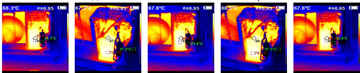
(ค) ภาพถ่ายความร้อนเมื่อค่าคาปาซิเตอร์คอมเพรสเซอร์มีค่า 27\ \mu F
